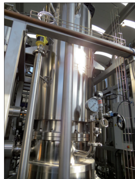
Obr. 2. Radarový hladinoměr Vegaflex 83 v obtokovém stavoznaku generátoru páry
