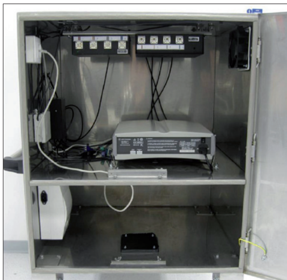
Obr. 1. Hlavní jednotka diagnostického systému MOSAD®-MST-PD (VUT v Brně)
