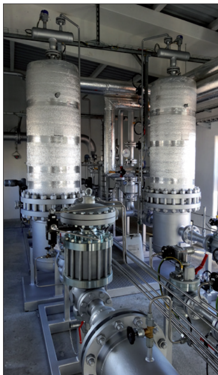
Obr. 3. Technologická část regulační stanice zemního plynu
