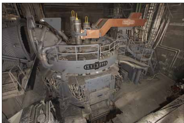
Obr. 1. Elektrická oblouková pec ve španělské ocelárně Saralle
