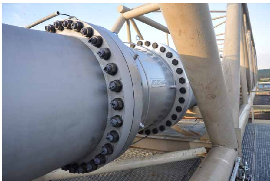
Obr. 1. Snímač průtokoměru Krohne UFM 3030 DN 1200 PN25 v potrubí DN 1200
