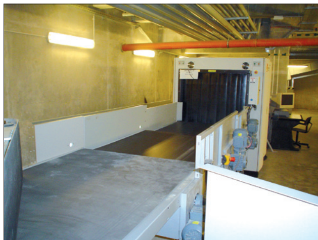
Obr. 1. Jeden ze tří skenerů pro automatickou kontrolu obsahu zavazadel připojených k řídicímu systému B&R
