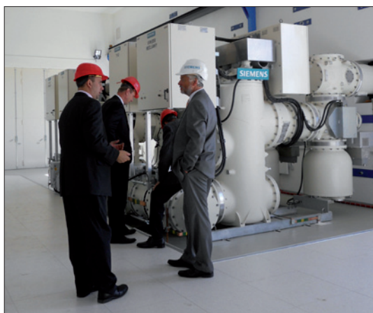
Obr. 1. Účastníci slavnostního otevření transformovny v Moravanech u Brna při exkurzi před zapouzdřenou rozvodnou
