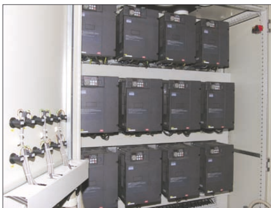
Obr. 1. Sestava dvanácti měničů frekvence Mitsubishi Electric FR-F 740 v systému pohonu čerpadel v čistírně odpadních vod společnosti Aha, Hannover
