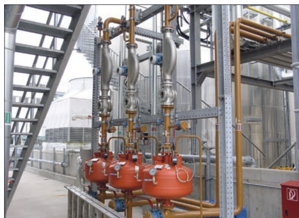
Obr. 1. Stanice na nakládání bionafty s Coriolisovými hmotnostními průtokoměry
