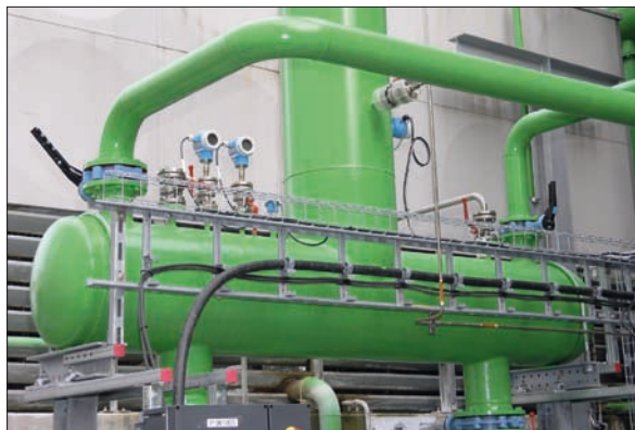
Obr. 2. Měřicí přístroje Endress+Hauser v chladičím systému výroby bionafty
