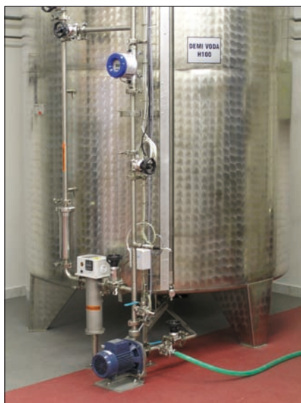
Obr. 1. Plovákový průtokoměr H250 Food (uprostřed nahoře) v regulační smyčce průtoku demineralizované vody (zdroj: Krohne)
