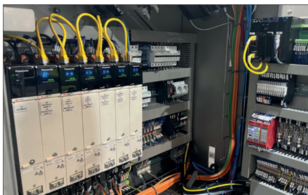
Obr. 2. Pohled do rozváděče stroje
