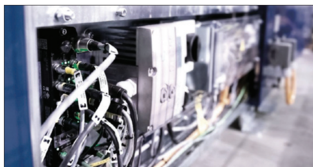
Obr. 3. V chladírenském skladu jsou použity I/O moduly TBEN-L s rozsahem pracovních teplot od -25 °C a krytím IP67
