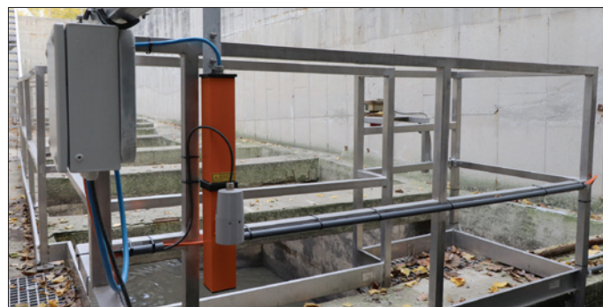
Obr. 2. Instalace detektoru ROW v nátokovém žlabu
