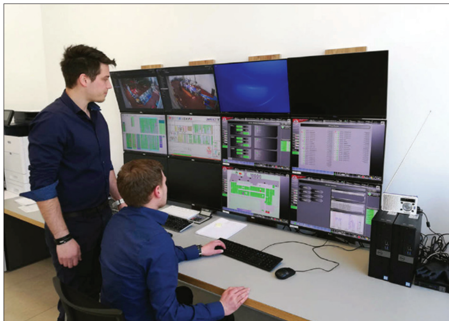
Obr. 2. V řídicím středisku každého výrobního závodu jsou na několika monitorech systému přehledně zobrazeny všechny provozní stavy
