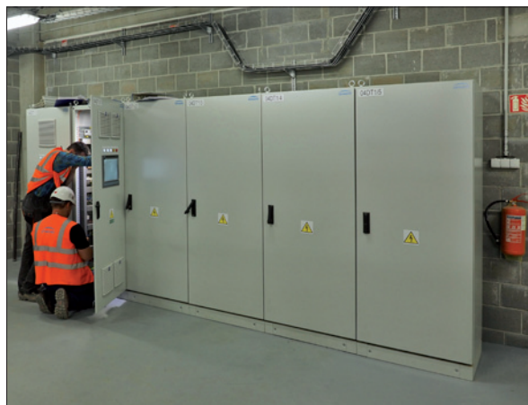
Obr. 2. V roce 2018 dodala společnost Engie do ústřední čísteřny odpadních vod v Praze 6 veškeré elektrosoučásti NN i VV včetně ŘS rozveden
