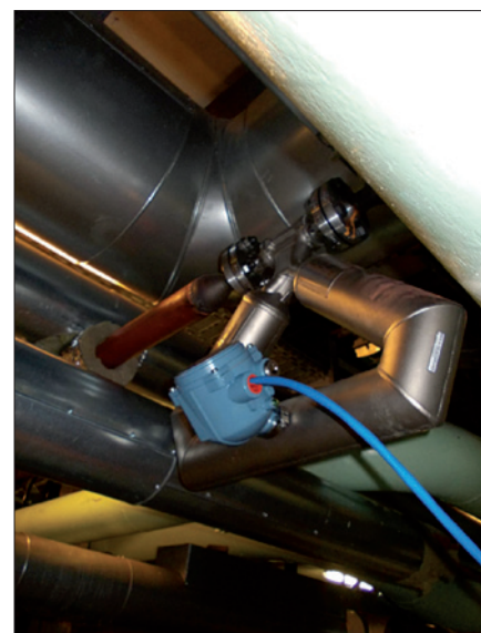
Obr. 10. Coriolisovy průtokoměry Micro Motion instalované v experimentální laboratoři parních turbín ve společnosti Doosan Škoda Power
