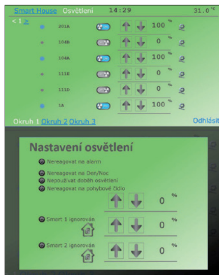
Obr. 6. Podobně jako žaluzie lze také sledovat a ovládat stav osvětlení z přehledové obrazovky (nahore) a z ní rovněž přejít do nastavení individuálních řídicích podmínek pro každé světlo (dole)
