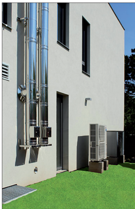
Obr. 2. Pohled na jižní stranu domu – venkovní jednotka tepelného čerpadla je umístěna před domem, komínová tělesa na fasádě patří k bivalentnímu zdroji, který je aktivován při nejnižších okolních teplotách
