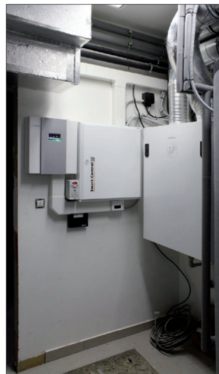
Obr. 3. Jednotka Smart Control je umístěna v technické místnosti společně s rekuperační ventilační jednotkou
