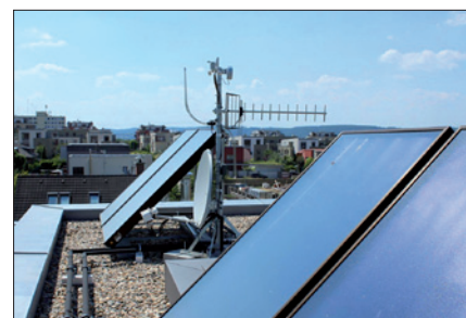
Obr. 8. Střecha rodinného domu s instalovanými solárními termickými panely, meteostanicí a komunikačními anténami pro spojení se světem je nedílnou součástí TZB
