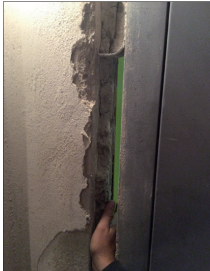
Obr. 1. Příklad závady výtahu – poškození dveří
