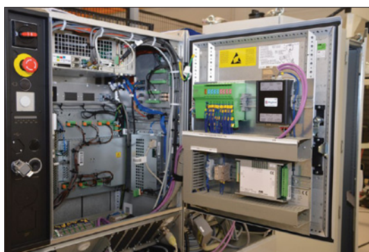
Obr. 3. Rozváděč s instalovanou komunikační branou Anybus X-gateway
