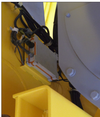
Obr. 4. Modul B&R MA170 umístěný na šasi v bezprostřední blízkosti bloku naftového motoru
